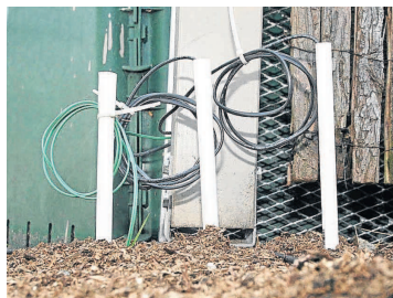
Im Boden werden Wärme und Feuchtigkeit gemessen.
